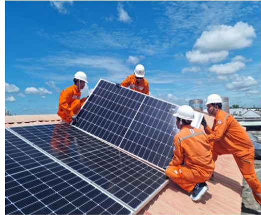
Gần 99% hệ thống điện năng lượng mặt trời mái nhà ở TP. Hồ Chí Minh được lắp đặt nhằm mục tiêu tự sử dụng tại chỗ. Ảnh: congnghiepmoitruong.vn
